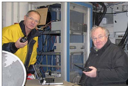
Norbert, OE1NDB (l.), und Kurt, OE1KBC, bei der Installation der Technik von OE1XQU am Wienerberg Foto: OE1KBC
