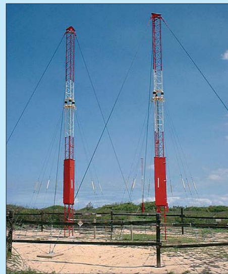
Phasengekoppelte Vertikalantennen für 15 MHz bei der Station WWVH auf der Kauai-Insel, Hawaii, USA Fotos: OK1DUB (1), NIST (1)
